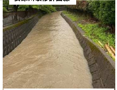
馬場川水門下流洪水状況(7/12)
